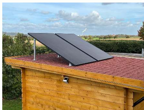
Die Mini-PV-Anlage von Herrn Wegwitz im Betrieb auf dem Dach des Gartenhauses.
