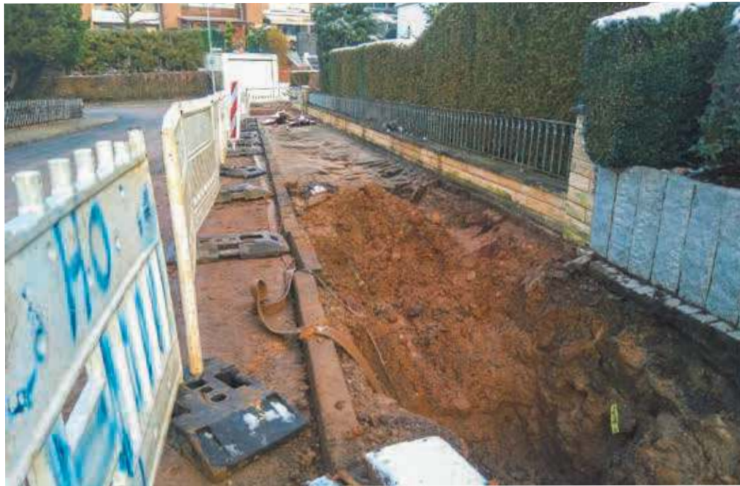
Folgeschäden der geplatzten Wasserleitung in der Schützenstraße
