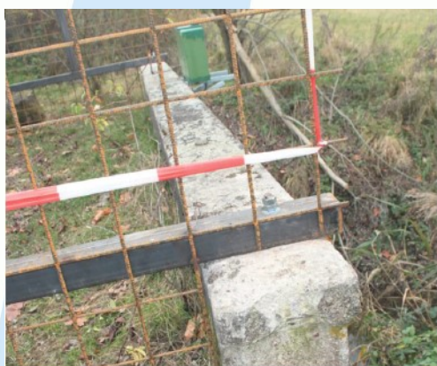
Die Brücke ist einsturzgefährdet, so das Ergebnis einer Prüfung der Stadt Springe. Aber die Befestigung des Bauzauns scheint kein Problem für das Mauerwerk zu sein. FOTOS: KLEIN
