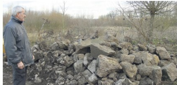
Nur noch ein Trümmerfeld: Hallerburgs Ortsvorsteher Hans Jürgen Pompetzki steht vor dem Überbleibsel der Hallerbrücke von 1913. „Eine neue Brücke ist jetzt das A und O“, betont er.
